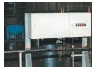
Шкаф управления сервоподвесок
